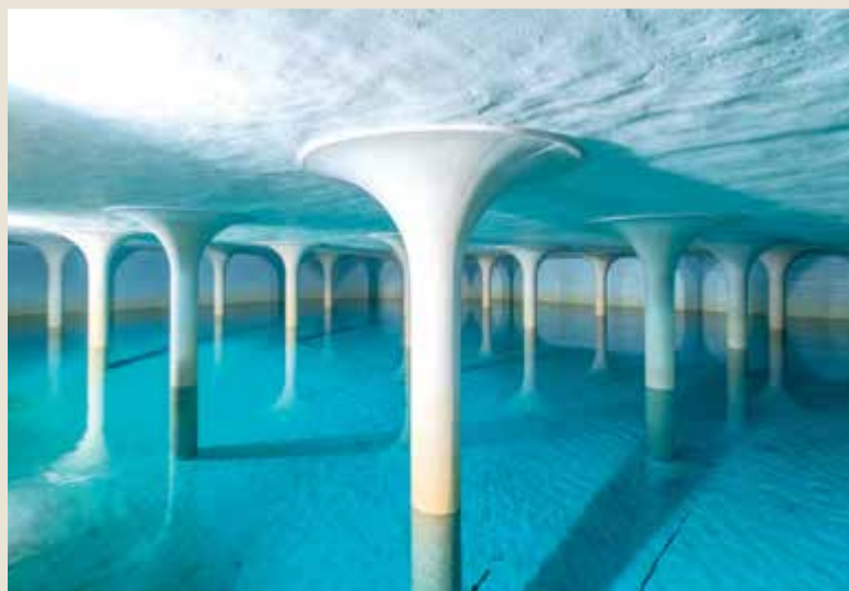
Das Trinkwasser-Reservoir aus den Quellen im Langenauer Wasserschutzgebiet ist wichtiger Bestandteil der Landeswasserversorgung.
