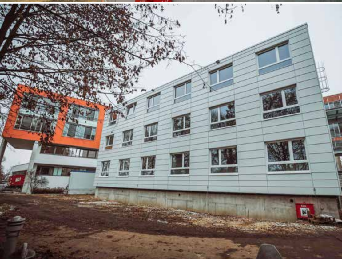
Auch bei mehrstöckigen Containerbauten ist ein solides Fundament die Grundlage. Der Anbau der Stiftungsklinik Weißenhorn ist vom Hauptgebäude aus erreichbar. Fotos: Patrick Fauß, Dave Stonies
